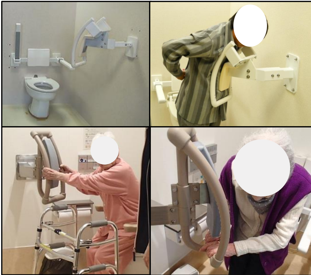
写真2 壁から飛び出したトイレの手すり
